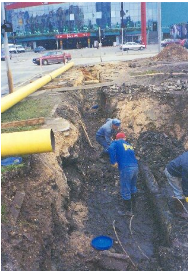
Slika 7.10 Polaganje gasovodne mreže u pliće iskopanom rovu bez zaštitne oplata u okviru izgradnje dijela sjeverne longitudinalne u Sarajevu (Foto: Gracić O., 2006)
