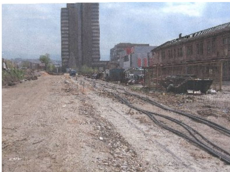
Slika 7.7 Izgradnja dijela sjeverne longitudinalne u Sarajevu uz polaganje kablovskih mreža (Foto: Grcić O., 2006.)
